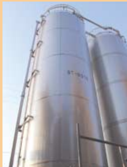
200トン液糖貯槽タンク
